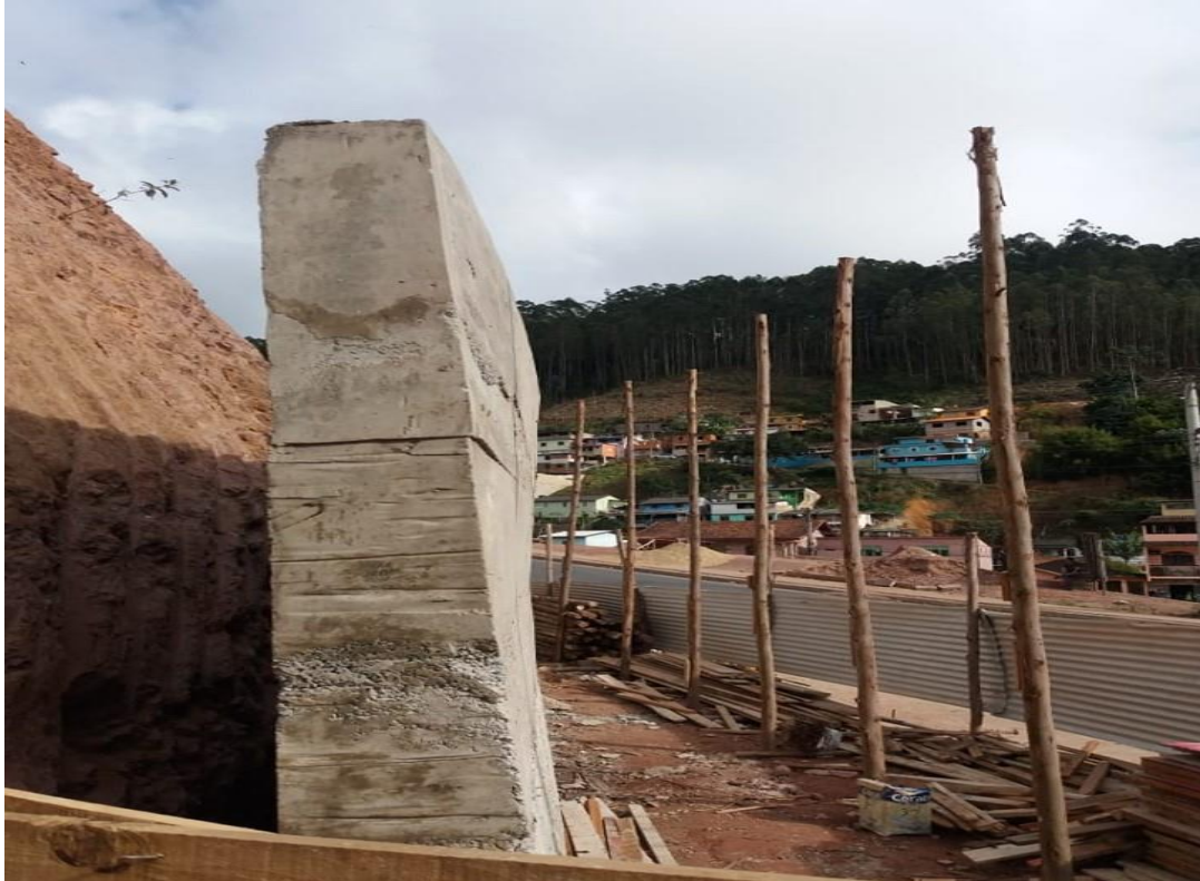
Foto 01 - Estrutura em concreto com imperfeições.
