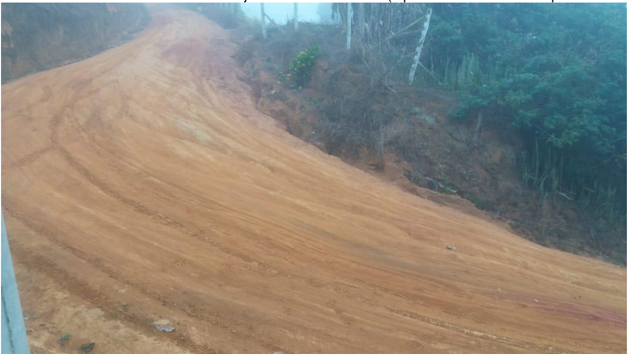
Foto 2 - vista de outro ângulo da curva em questão. Há a necessidade da pavimentação (trecho de aproximadamente 200m)
