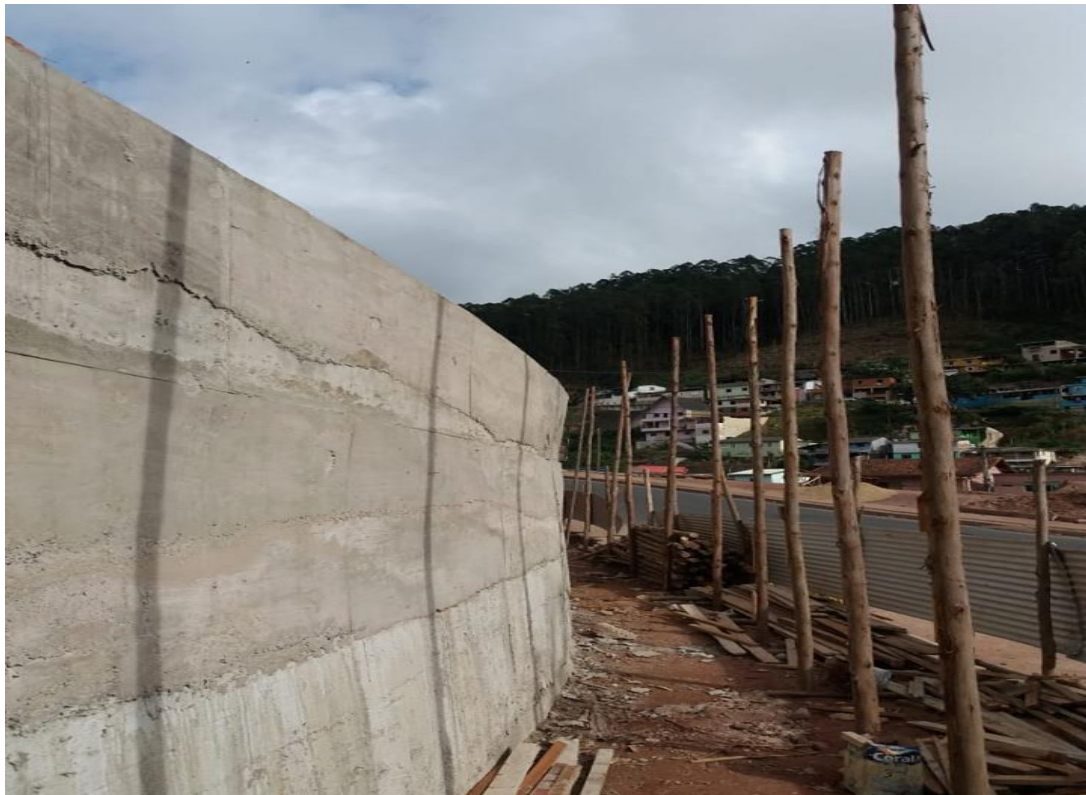
Foto 02 - Estrutura em concreto com imperfeições.
